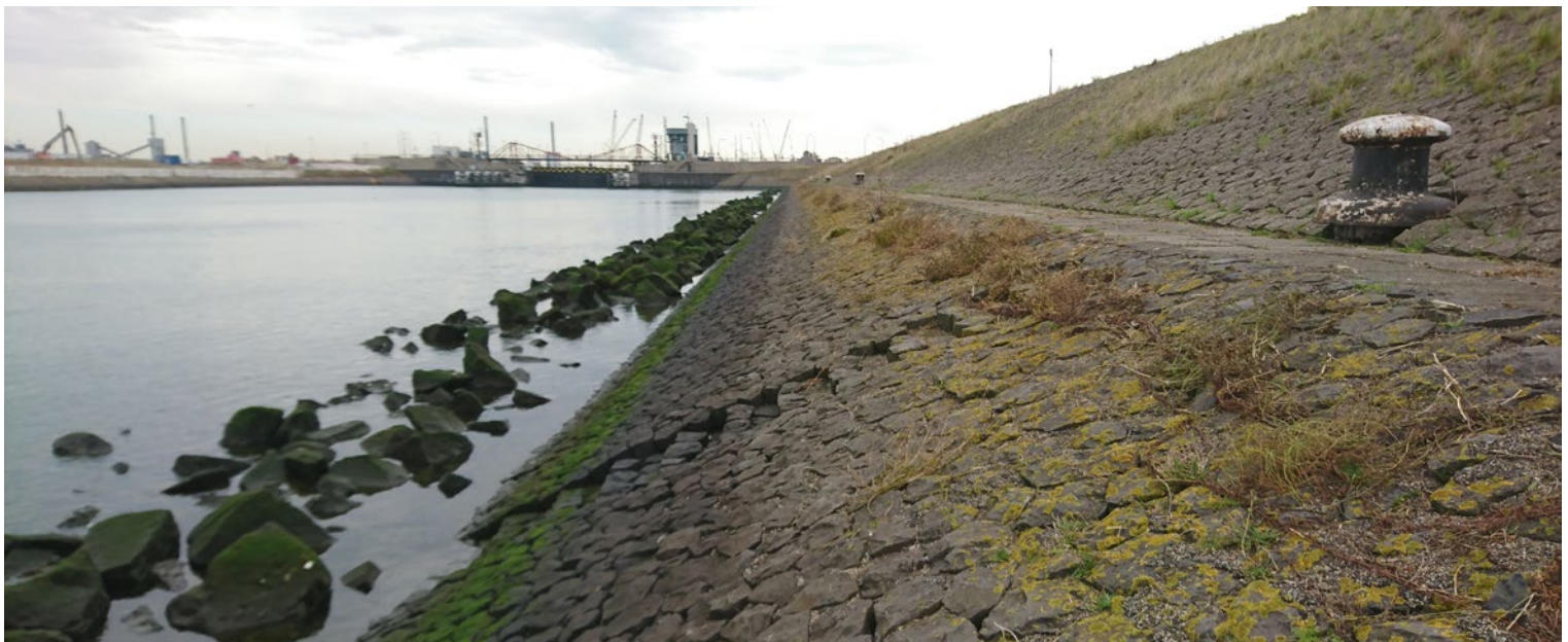
Referentie van trappartij in het benedenbeloop. In de huidige situatie zijn de traptreden geïntegreerd in de zetsteen bekleding.
