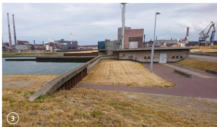
Bij de Spuisluis snijdt het dijklichaam in een keermuur die de waterkering vormt.
