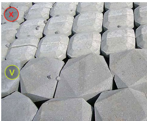
Referentiebeeld van ongewenste regelmaat en gewenste onregelmaat in de gesloten steenbekleding (zetsteen)
