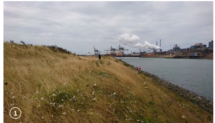
Kenmerkend profiel van de dijk met een grasbekleding op het bovenbeloop en hoge berm, zetsteen op het middenbeloop (met gras begroeid) en onderbeloop en stortsteen aan de teen.
