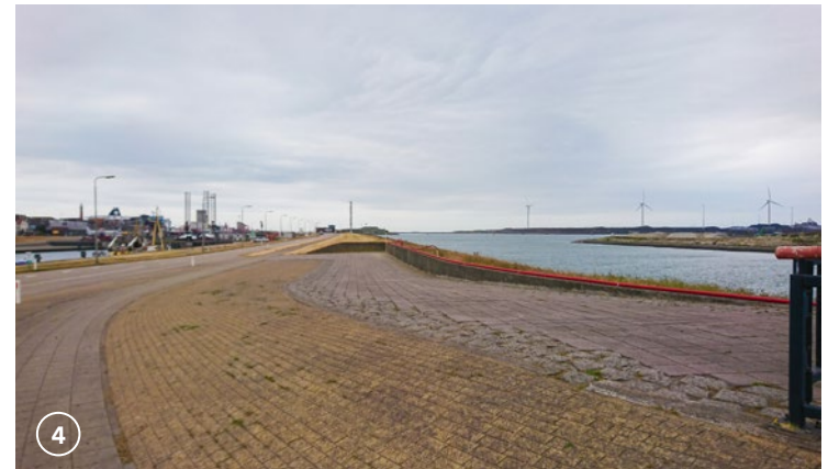
Om de toegang tot het werkplateau voor de Middensluis mogelijk te maken is de dijk afgesneden door een keerwand. De aansluiting van de dijk op de Middensluis is hierdoor erg stenig en ook hier zijn veel verschillende types verharding toegepast.
