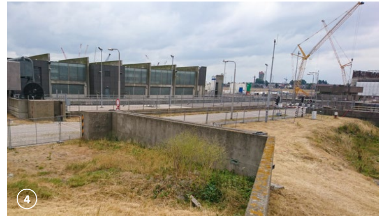
bij de Noordersluis snijdt het dijklichaam in een keermuur die de waterkering vormt. Aan de buitendijkse zijde is een roldeur aanwezig die bij hoogwater in de coupure gerold kan worden.
