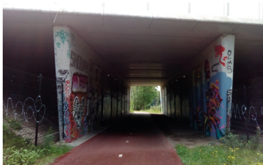
^ A28-Zuid, KW Ponlijn en Dorresteinseweg: In de huidige situatie is dit al een sociaal onveilig kunstwerk door de brede kolommen. Door de verbreding van de snelweg wordt de onderdoorgang nog langer.
