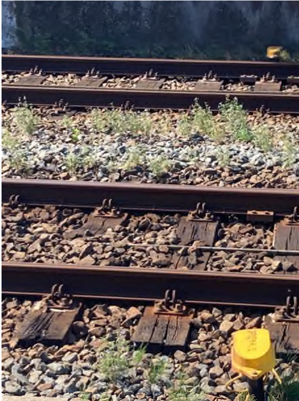
Figuur 4.21 Waarneming van smalle raai in het ballastbed aan de zuidzijde van station Uitgeest ter hoogte van km 58.4 op 22 augustus 2022.
