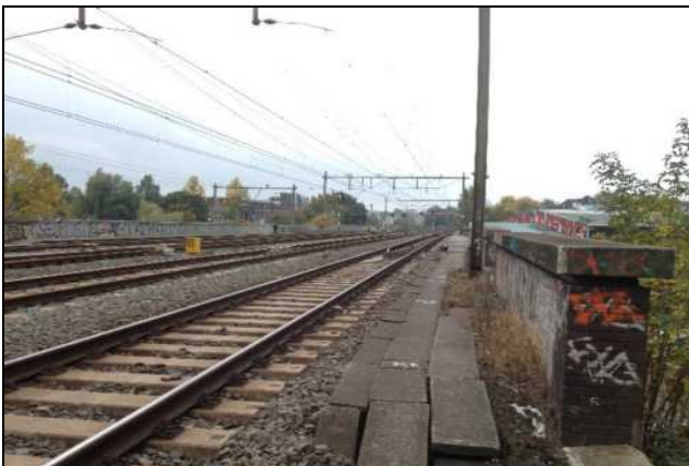
Zicht op het spoorviaduct over de Cruquiuskade. Gezien vanaf het schouwpad in zuidelijke richting.
