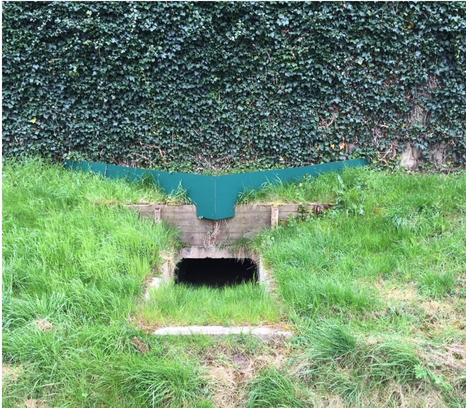
Foto 2.7 Onder het spoor ligt op regelmatige afstand een faunapassage, bestaande uit een ruime vochtige duiker.
