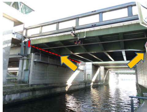
Figuur 44: Afsluiting van de onderkant en zijde van de voegen aan weerszijden van de brug ter reductie van piekgeluid van voegpassages.
