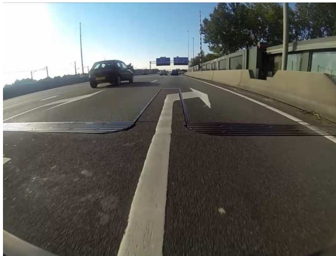
Figuur 7: Foto van de wegdekvoeg (westzijde, kant basculekelder).
